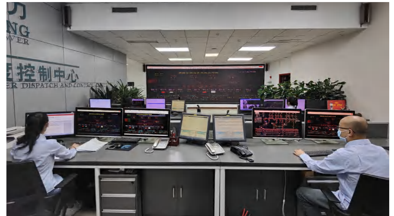
明星电力电力调度控制中心
